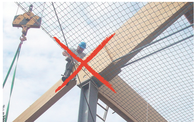
7 Wirkungsloses Auffangnetz mit ungenügendem Überstand zur Absturzkante
