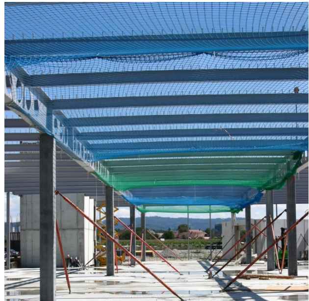
1 Mit Auffangnetzen lassen sich Personenabstürze ins Innere des Bauwerks verhindern.
